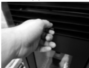
Figura 14 - Limpieza del intercambiador de calor
